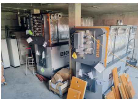
Die neuen Heizkessel vor der Verkleidung
