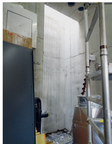
Schacht für Kamine
