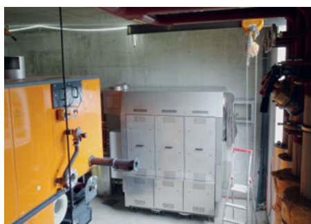
Die neuen Filteranlagen beanspruchen viel Platz
