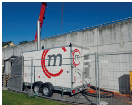
Die Notheizung mit einer Leistung von 300 kW
